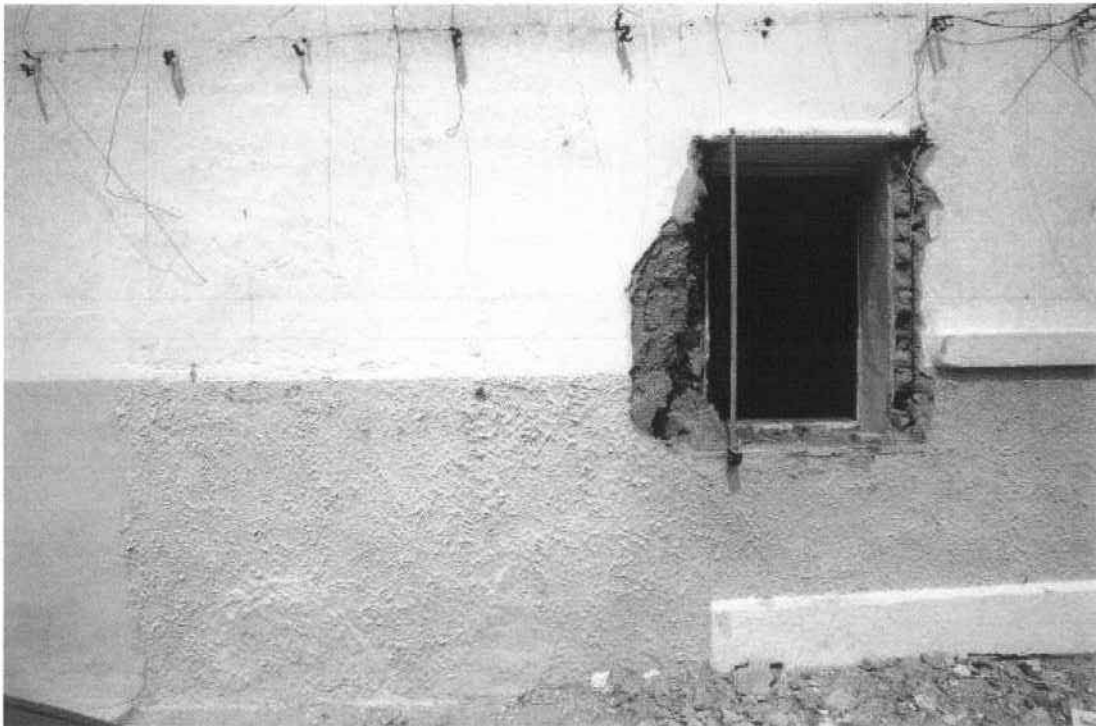
Situación inicial de la cata donde se aprecia la rotura de la ventana sur de la fachada
