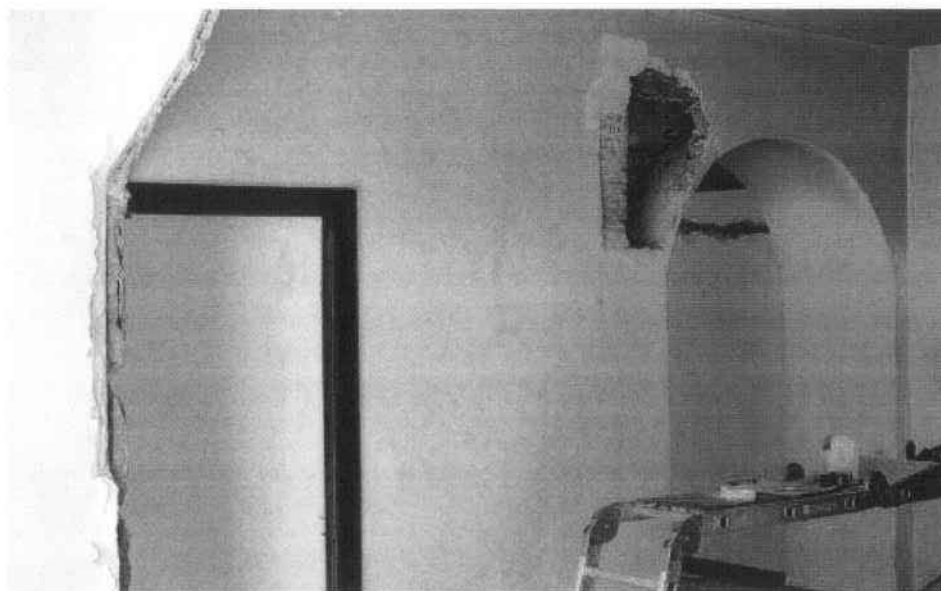
Vista del muro sur de la vivienda y el vano actual hacia a la cocina y antiguamente al patio
