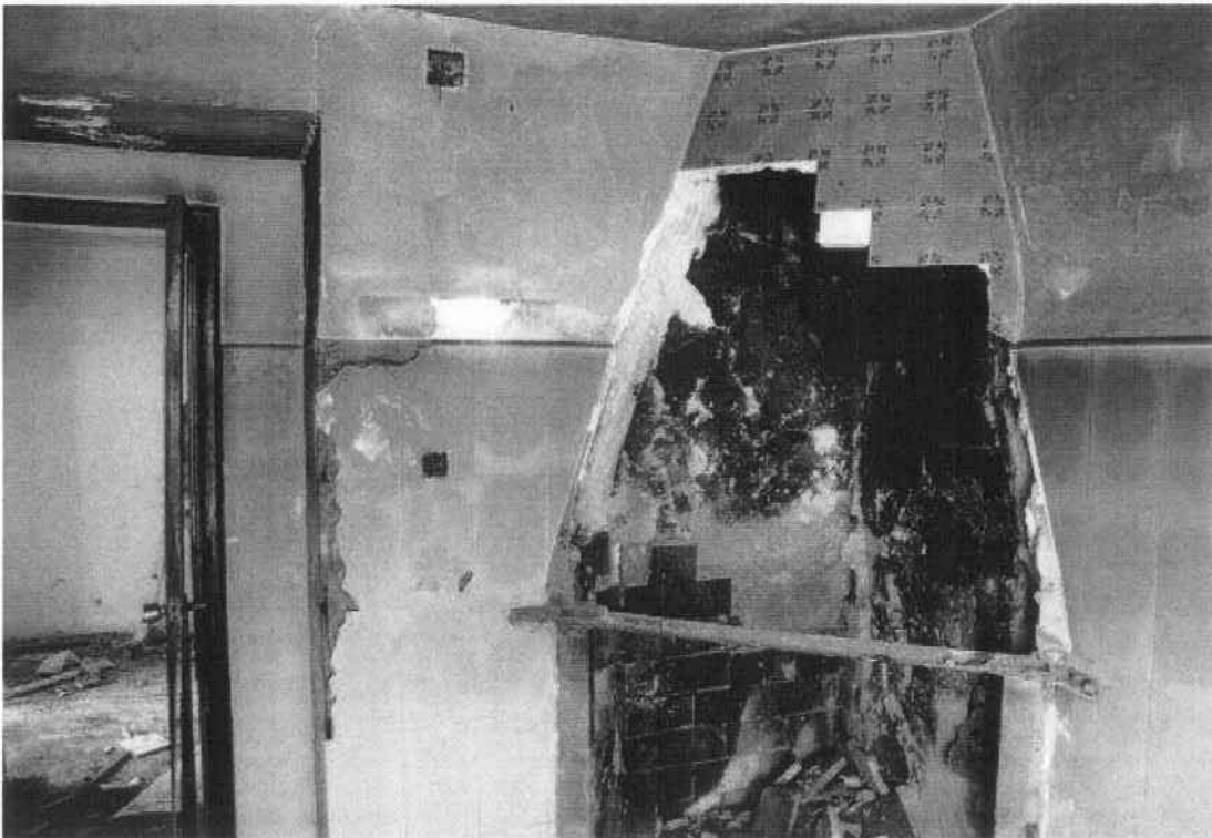
Estado inicial del paramento norte del muro de la antigua fachada principal. Cata 7b
