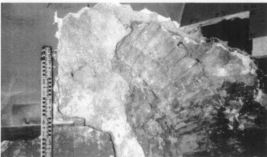
Vistas generales y detalles del arco de medio punto de la puerta de la fachada principal, cortado para la construcción del vano actual de paso interior, por lo que únicamente se conserva su jamba oeste y parte del desarrollo del arco
